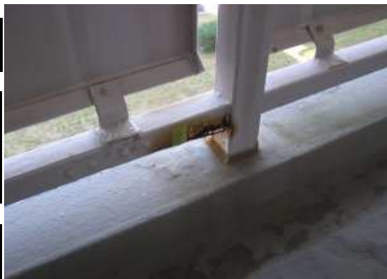
固定部分の腐食例
