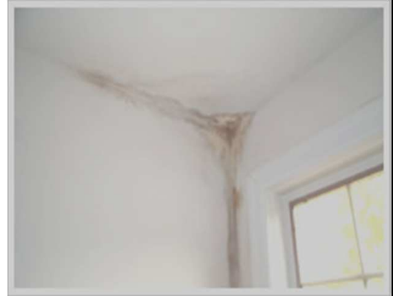
ひび割れからの漏水痕跡例
