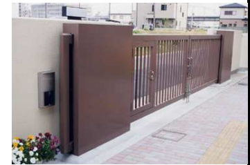
フェンス固定部の腐食例
