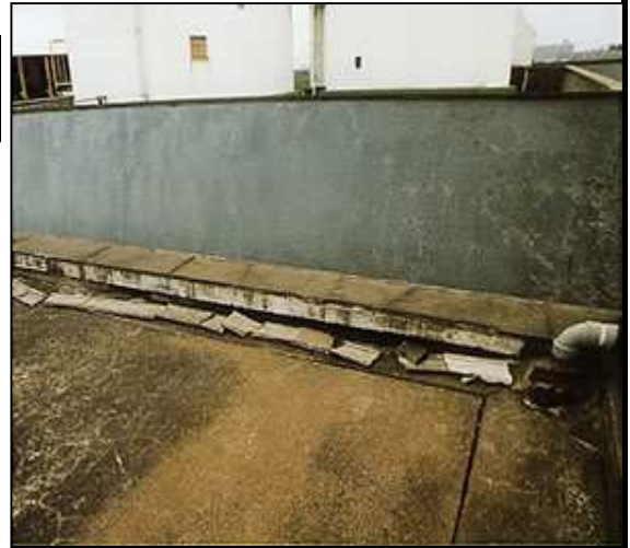
モルタルの剥落例
