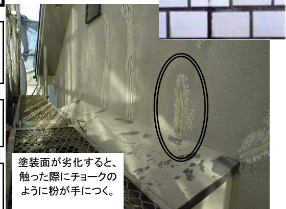
外壁のひび割れ例
