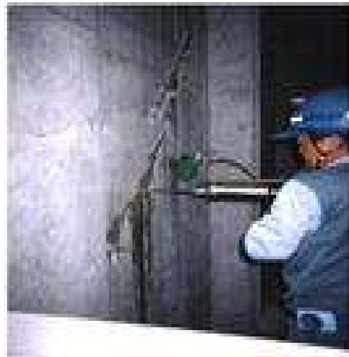
壁面からの漏水例
