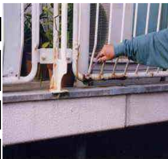
手すりの腐食
