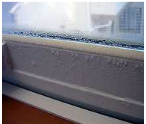
窓の結露の例
