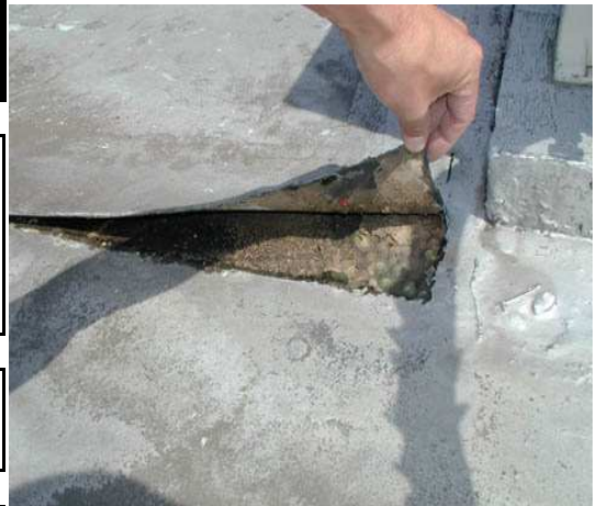
シート防水の劣化の例
