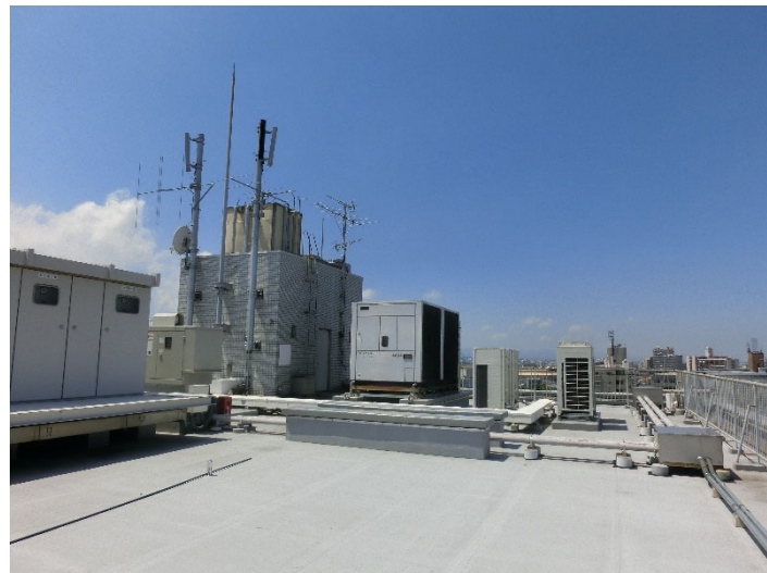
左からキュービクル、機械室、ヒートポンプチラー、室外機
