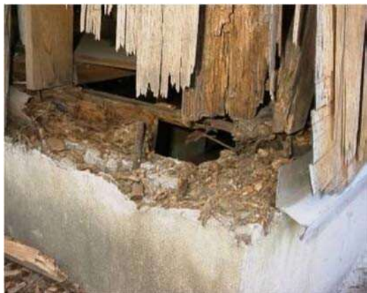
蟻害が発生し欠損している
