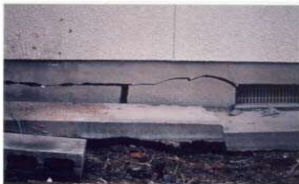
基礎が大きく破損している
