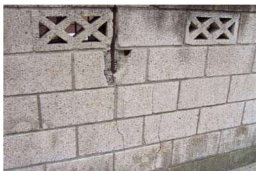
塀に大きなひび割れが生じている
