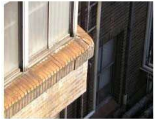
外壁に浮きが生じている
