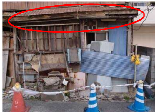
軒に不陸、剥離が生じている
