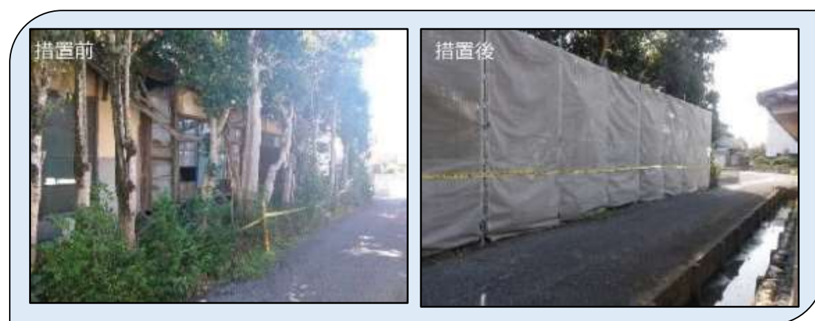
▲ 空き家等の応急措置の事例
