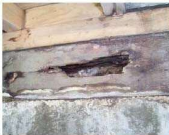
土台に蟻害が発生している
