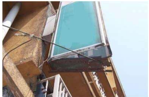
底板に腐食が発生している
