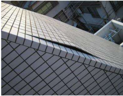
外壁に浮きが生じている
