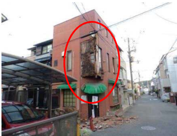
外壁が破損している
