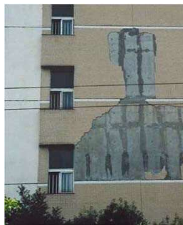
外壁に脱落が生じている
