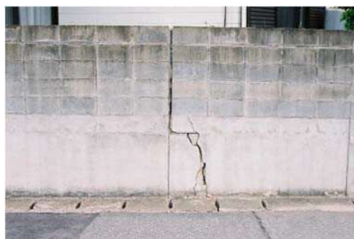
塀に大きなひび割れが生じている
