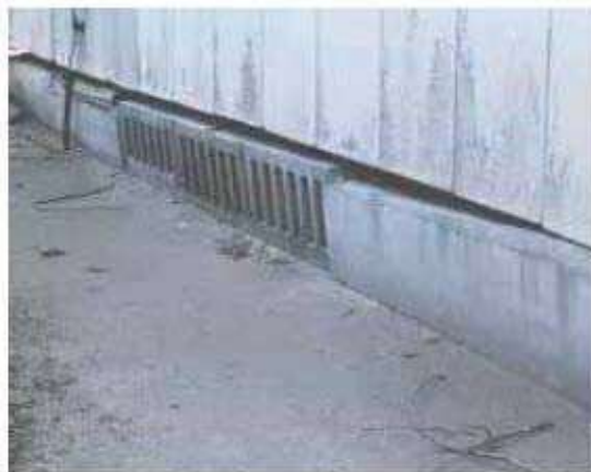
基礎が沈下し破損している
