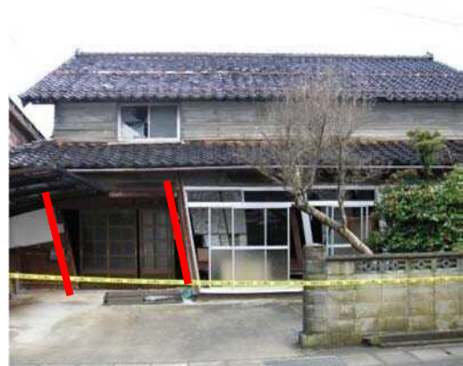
1階部分が傾斜している
