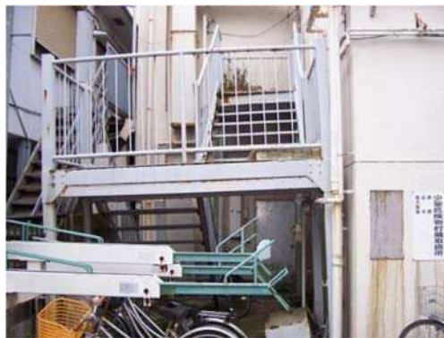
屋外階段が傾斜している
