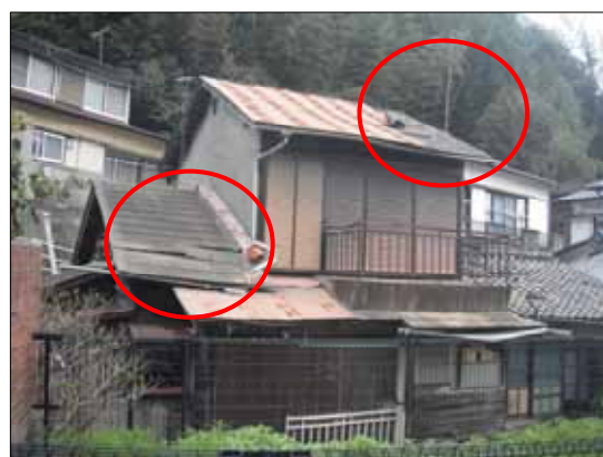
アスファルト屋根等の一部に ズレがあり、雨漏りのある例
