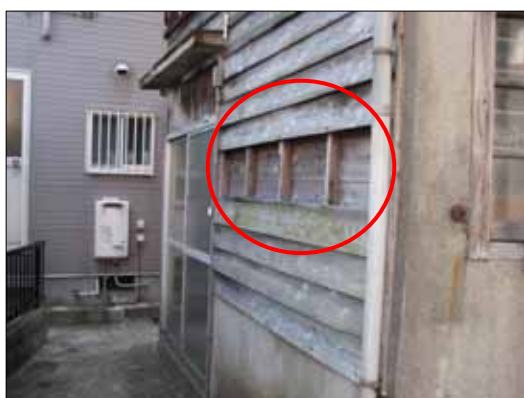
外壁の仕上材の一部がはがれ、 下地が露出している例
