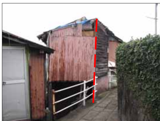
一部の柱が傾斜している例
