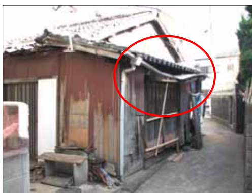
雨樋が壊れており、機能的には雨樋はないと同様の例
