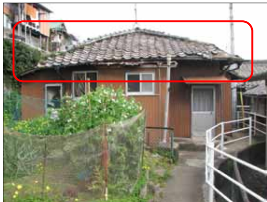
屋根に不陸がある例
