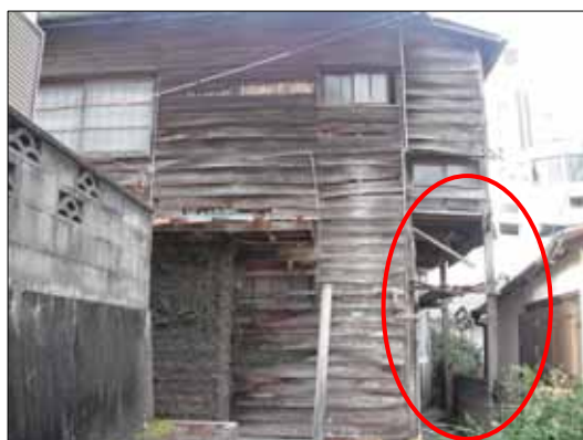
柱の数箇所に破損がある例
