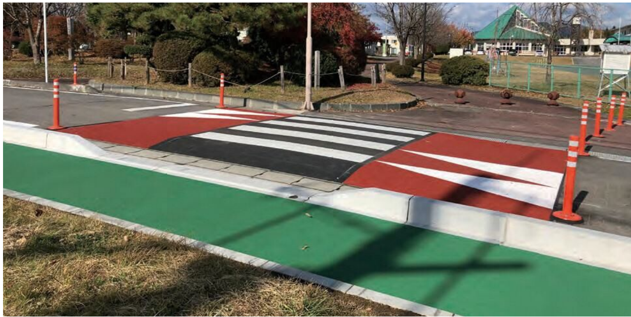
スムーズ横断歩道設置状況
