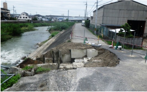
台風の影響で崩れた近木川右岸の護岸
