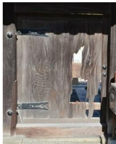
割れたくぐり戸の戸板（事件翌日） ※現在は仮修理をされています。
