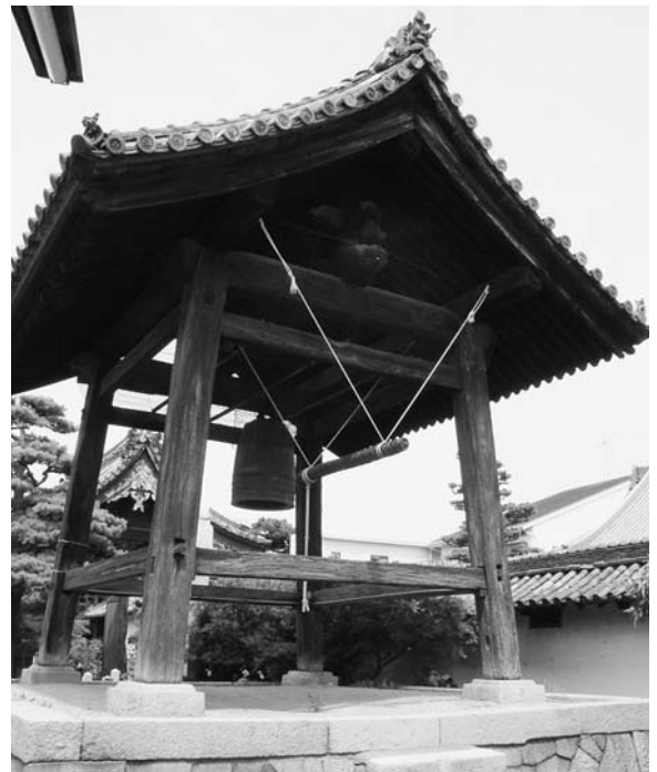
修理前の鐘楼
