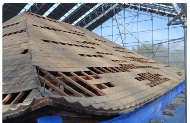
写真3 屋根瓦の下にある野地板とそれをめくると現れた垂木（令和2年3月16日撮影）
