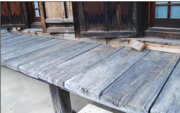
写真⑧ 木割れが生じていた修理前の棧唐戸と縁板
