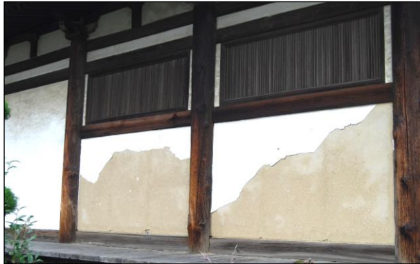
写真⑤ 漆喰がはがれていた修理前の漆喰壁
