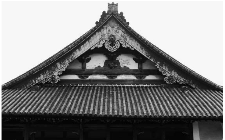
修理前の破風
