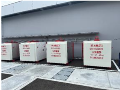
水素ガス貯蔵エリア
