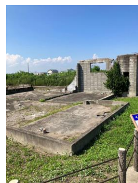
被害状況（住宅の基礎）
