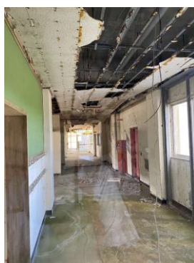
被害状況（廊下）
