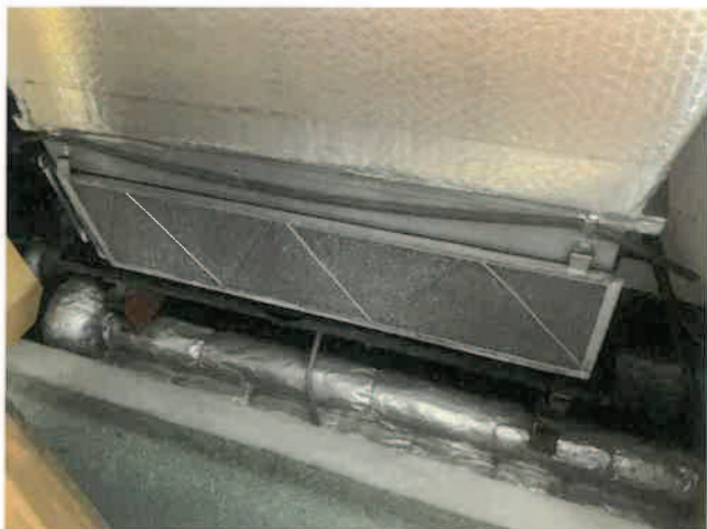
ファンコイル点検 外観点検
