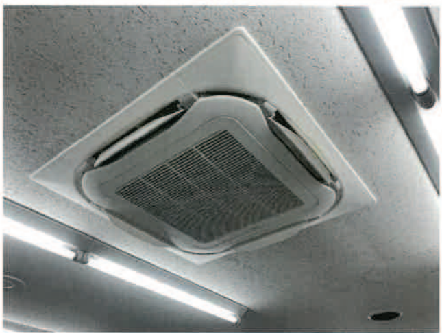
エアコン点検 室内機点検
