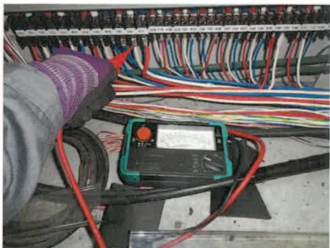
空気調和機点検 絶縁抵抗測定
