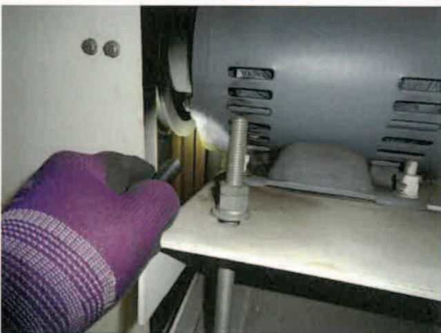
空気調和機点検 ファンベルト点検
