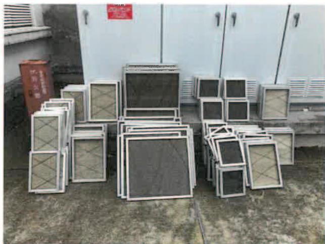
2024年5月31日 貝塚市民図書館 空調設備機器点検 エアーフィルター 清掃前
