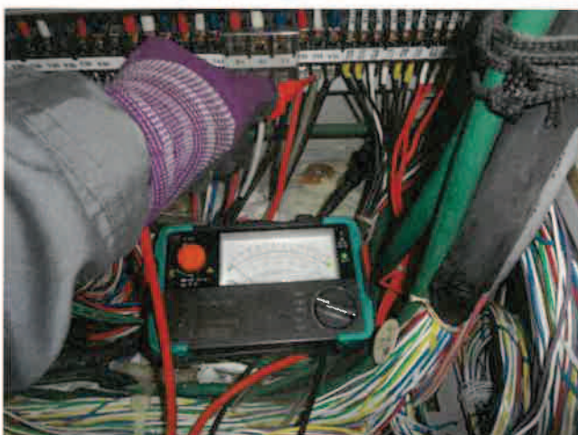
空気調和機点検 絶縁抵抗測定
