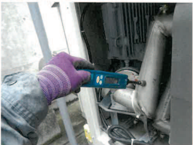
チラー点検 冷温水ポンプ点検 入口温度測定
