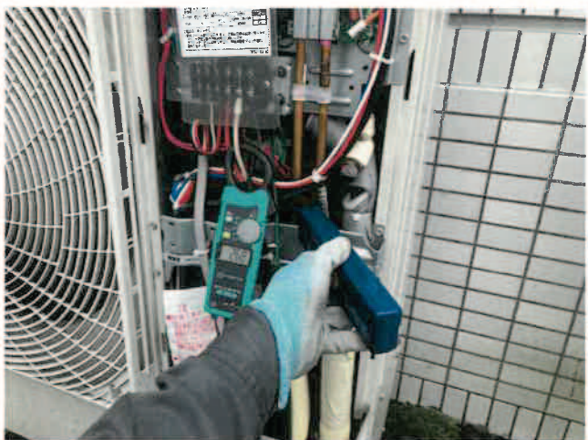
エアコン点検 室外機点検
