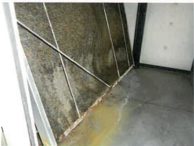
空気調和機点検 エリミネーター点検
