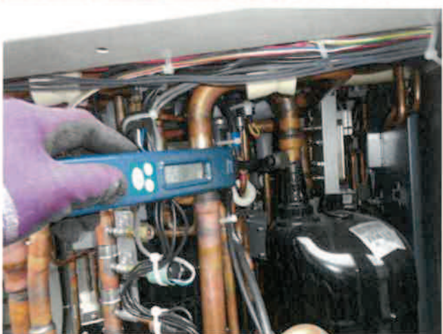
チラー点検 吸入管管温度測定
