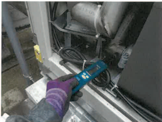
チラー点検 冷温水ポンプ点検 出口温度測定
