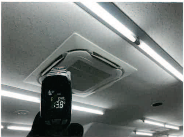
エアコン点検 室内機点検
