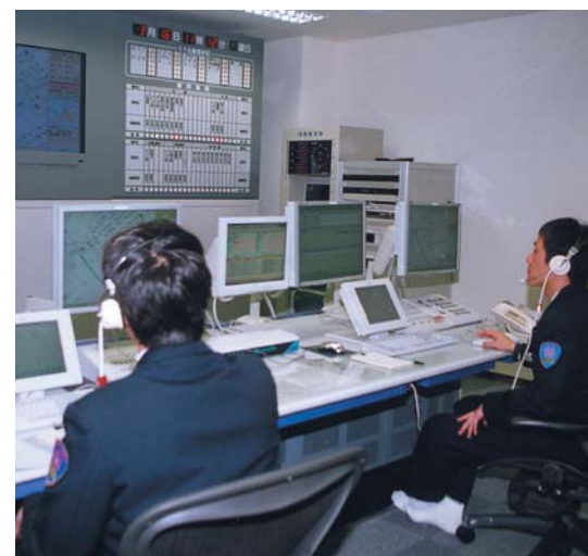
高機能消防指令センター
